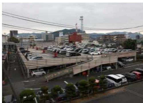
老朽化した中央駐車場
