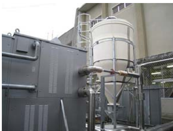
阿知須総合支所のペレットボイラー
