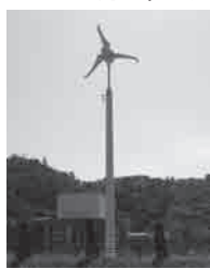
小型風力発電設備
