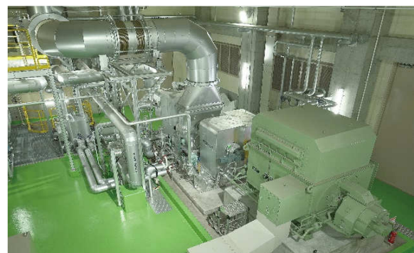
④ 蒸気タービン発電機
