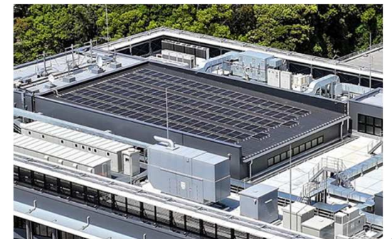
▲新本庁舎の太陽光パネル
