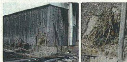
ハチの巣を狙って壊された建物
