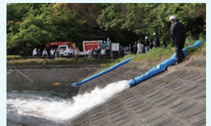
稼働中の移動式排水ポンプの様子
