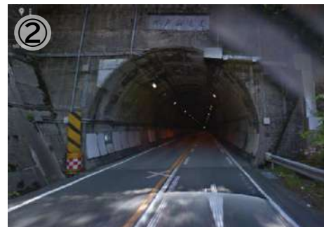
老朽化した木戸山トンネル(昭和36年完成)
