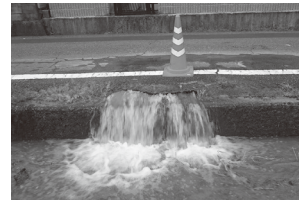
▲水道管からの漏水
