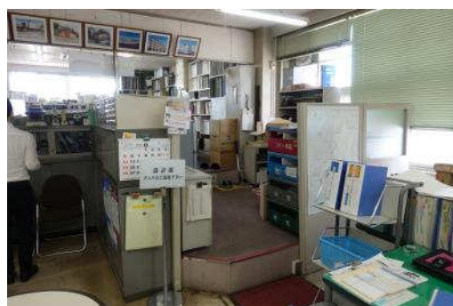
執務室内の段差
