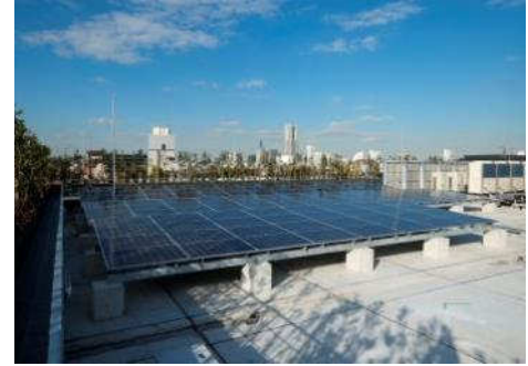
太陽光発電パネル（横浜市南区）
