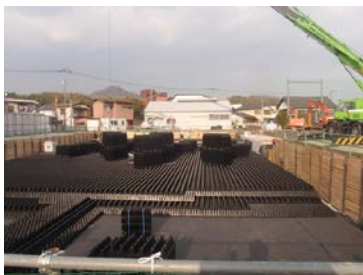
雨水貯留施設の整備 (参考: 田布施中学校地下貯留槽)
