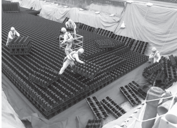
若宮雨水貯留浸透施設
